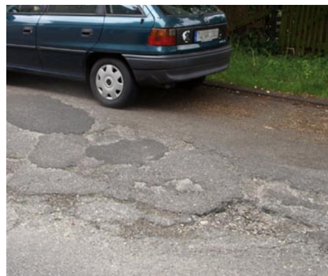
Straßenschäden dank App schneller beseitigen.
